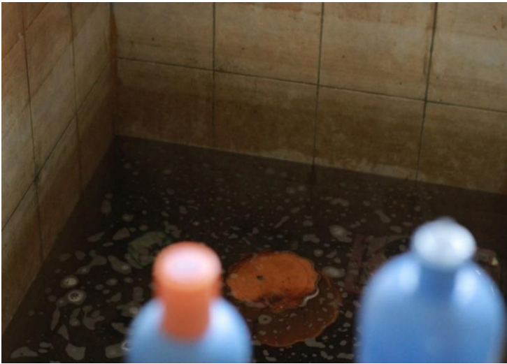
Kondisi Kamar Mandi Balai Desa Tambak yang kotor
