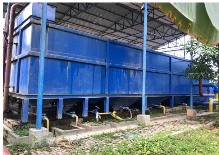
Gambar 4. Tanki Penampungan Air PERUMDA Wae Mbeliling Manggarai Barat
